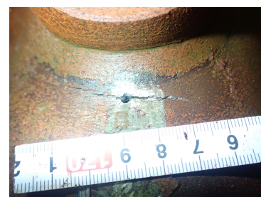
図9 No.7 のき裂の様子
