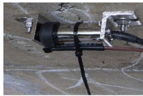
写-5 常時モニタリング(亀裂変位計)
