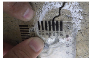
写-2 頂版ひび割れ( t=2.0\text{mm} )
