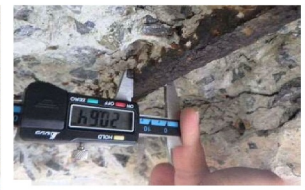
写-3 腐食度調査(D22 主鉄筋)
