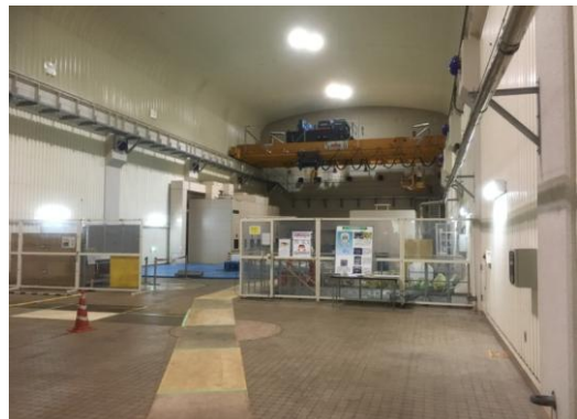
写真-2：沖縄やんばる海水揚水発電所の構内
