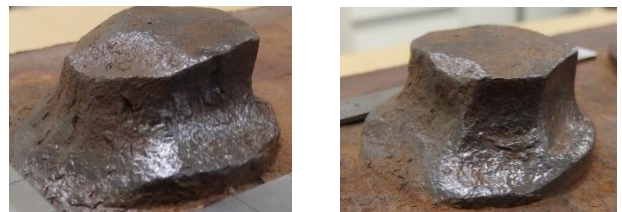
写真 4 頭部の一部が大きく減肉したボルト
