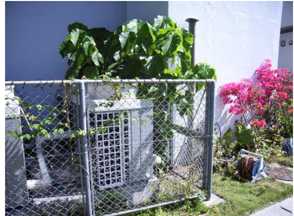
図 8 草木が生い茂っている屋外機
