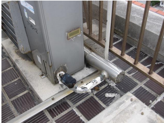
図 6 鳥害とみられる冷媒管
