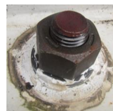
写真 2.2 つばのみ接着 ボルトの劣化状況
