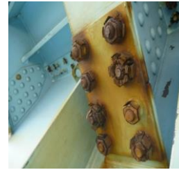
写真 1.1 高力ボルトの腐食状況
