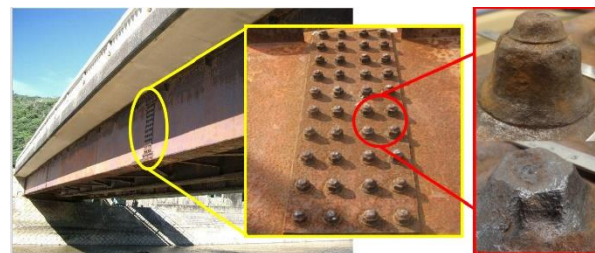
図1 摩擦接合継ぎ手と腐食減肉した高力六角ボルト
