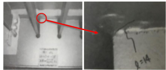
写真-1 疲労亀裂(1)
