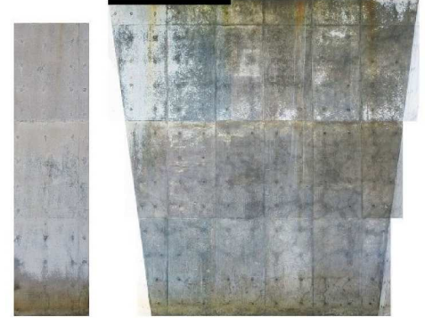
ひび割れ画像全体図 ※近接目視点検との整合性を確認した。
