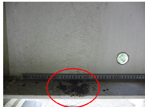
図11 桁内面フランジ部もらい錆
