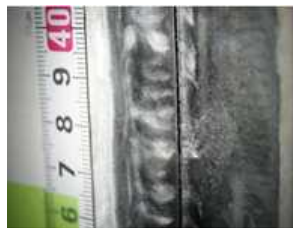
図-5 P174橋脚のき裂
