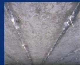
ASRゲルの滲出
