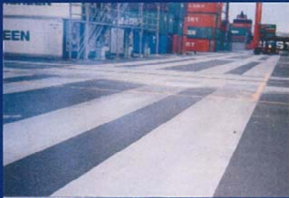
ひび割れ発生時期:施工後約2年
