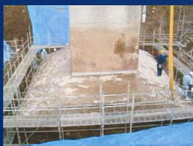
フーチングのASRによる劣化状況
