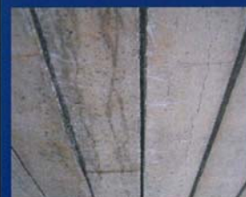
橋軸方向のひび割れ
