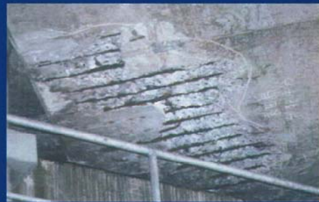
凍結防止剤による劣化事例 (中空RC床版, 高速道路)
