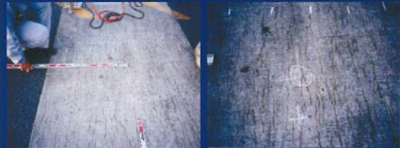
PC鋼線に沿ったひび割れ
