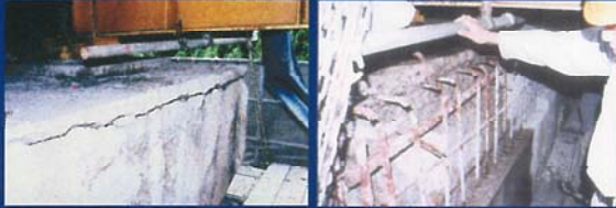
橋脚側面のひび割れ(枕梁)
