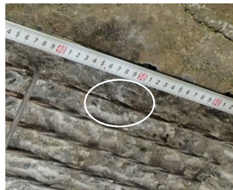
センサ0の直上にあるより線の計測位置50cm付近に素線破断
