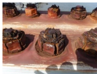
写真 1 ボルト部の腐食
