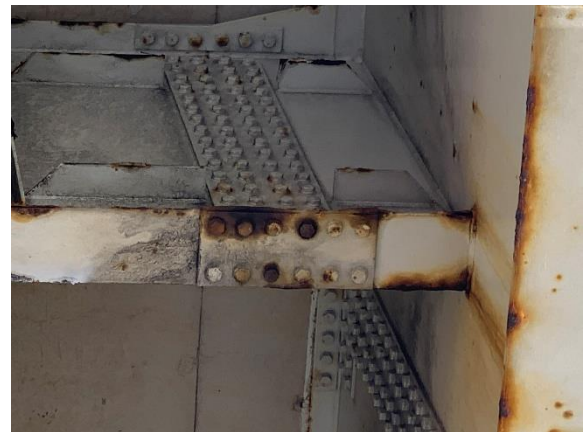
写真 1.1 腐食した鋼桁の例 (桁下から視点)
