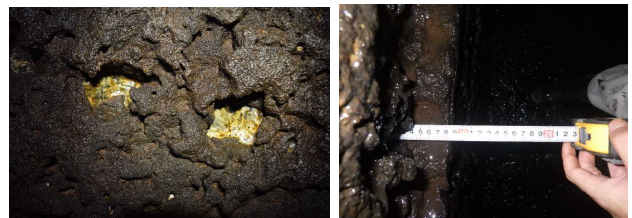
図-2 劣化状況写真
