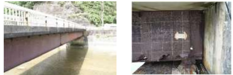
写真 1 鋼桁の腐食事例
