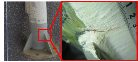
図-1 照明柱基部き裂
