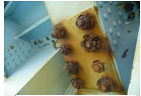
写真 1 腐食高力ボルト
