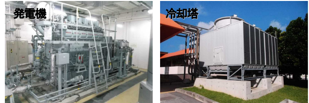
図-4 発電設備整備状況写真
