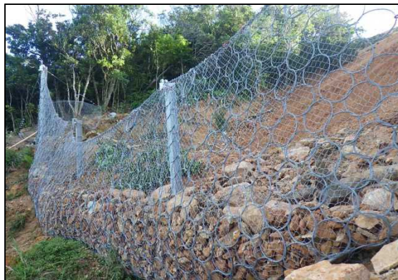
写真-7 落石堆積状況
