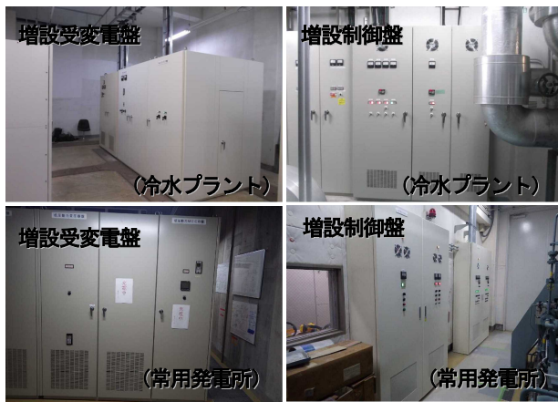
図-6 受変電・動力設備整備状況写真
