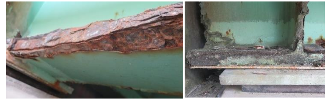
写真-1 腐食した鋼桁端部
