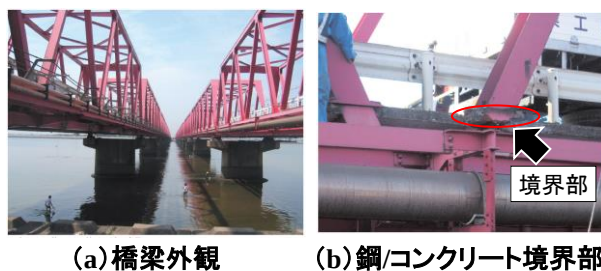
写真-1 下路トラス橋損傷事例1)
