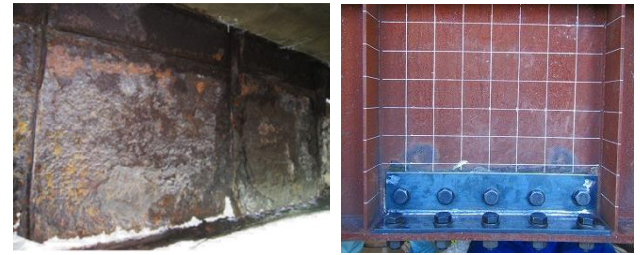
写真-1 腐食鋼桁橋
