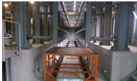
型枠装置(モールド装置)
