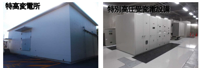
図-5 特別高圧受変電設備整備状況写真
