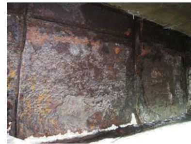
写真 1 鋼桁端部腐食事例
