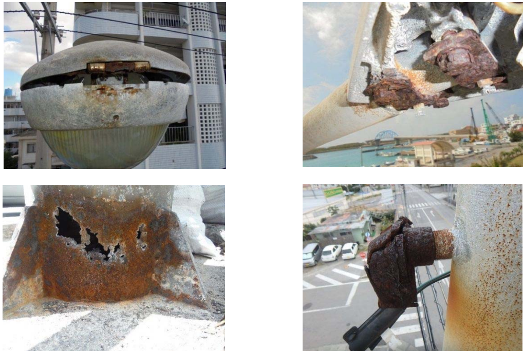
写真-3 損傷状況 上段左：灯具蝶番部の腐食破断 上段右：灯具取付部の腐食 下段左：支柱の孔食 下段右：配線部分の腐食損傷
