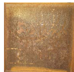
写真 3 ウェブ腐食試験体
