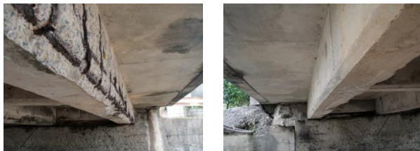
写真1 外来塩分による劣化
