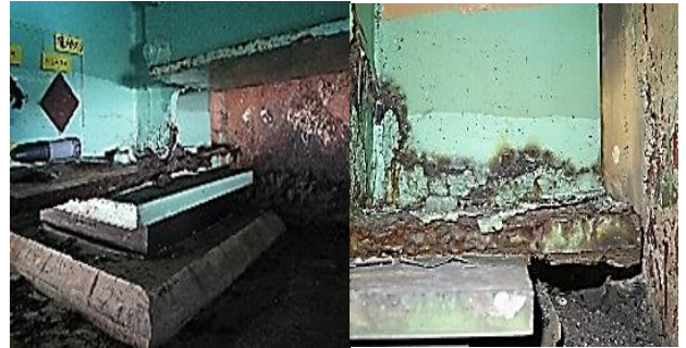
写真-1 桁端部が腐食した鋼橋
